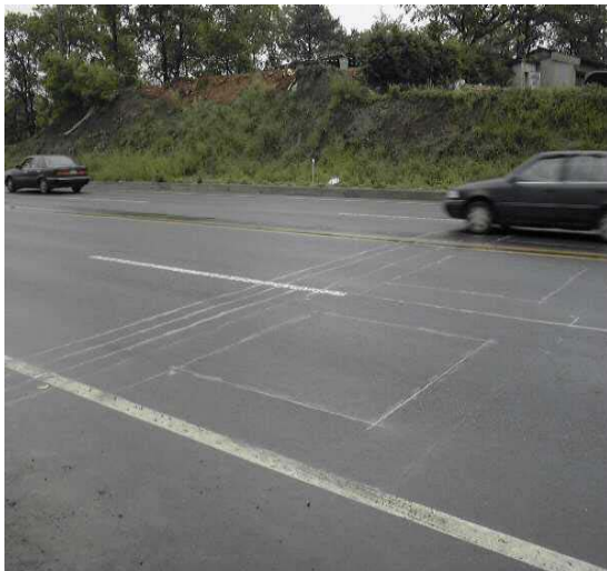
Ejemplo de lazos inductivos utilizados en instalación fija
