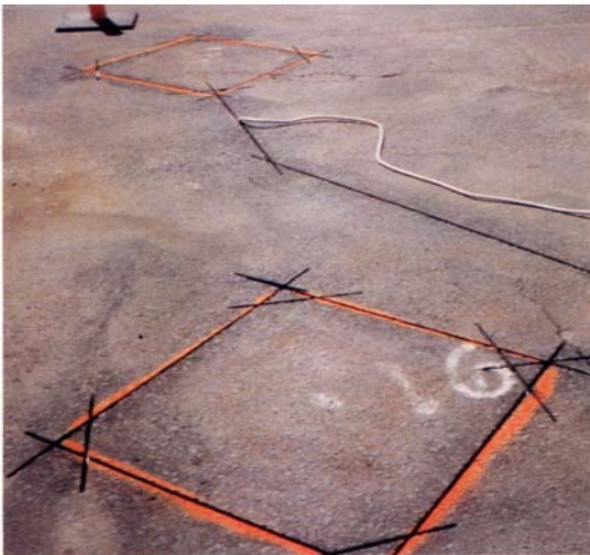
Lazos inductivos cuadrados con las esquinas achaflanadas
