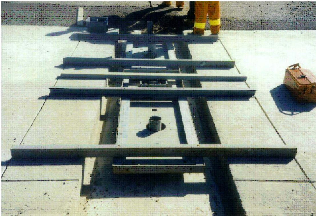
Fase de la instalación: bastidores colgados preparados para el vertido del concreto
